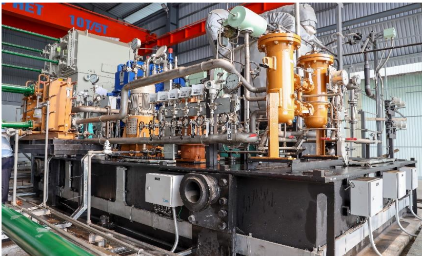
Tổ hợp lò hơi turbin phát điện sắp đưa vào vận hành theo kế hoạch
