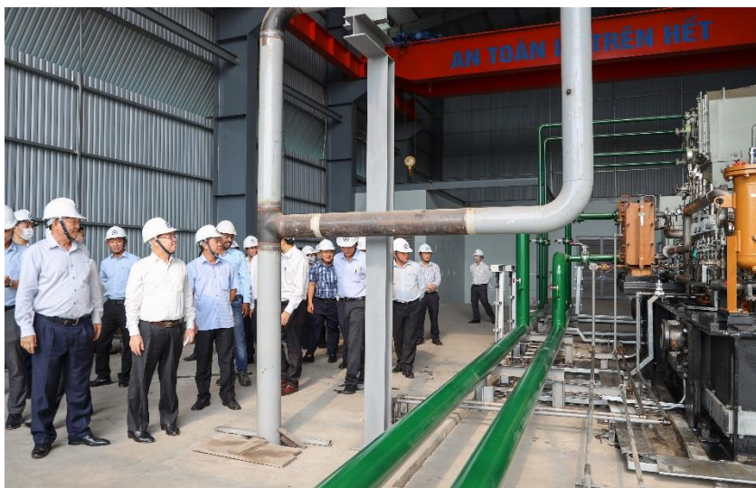
Bí thư Tỉnh uỷ Nguyễn Văn Lợi (thứ 2 từ trái sang) thăm tổ hợp phát điện 5MW sử dụng nhiệt từ lò đốt rác – lắp turbine phát điện.
