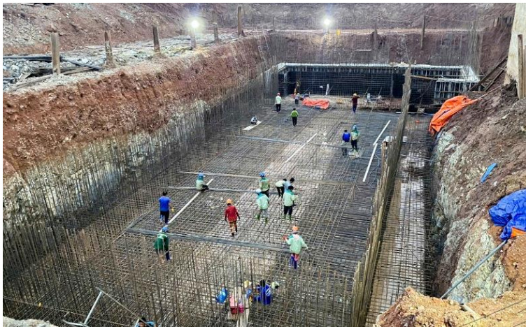
Hệ thống truyền tải, mương dẫn nước thô của GIWACO được đầu tư mới
