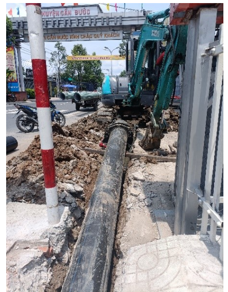
Ống D600 đưa nước sạch từ nhà máy nước Nhị Thành về Thị trấn Cần Đước – Long An
