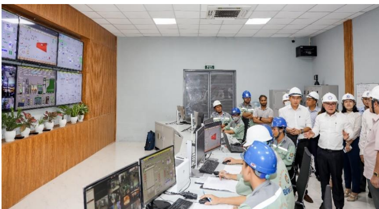
Đoàn công tác Thường trực HĐND tỉnh Bình Dương thăm phòng điều khiển trung tâm lò đốt rác thải thu hồi nhiệt phát điện BIWASE
