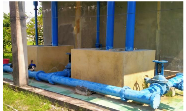
Nhà máy nước Minh Hưng Hàn Quốc sử dụng nguồn nước ngầm vừa được Biwase tiếp nhận khai thác
